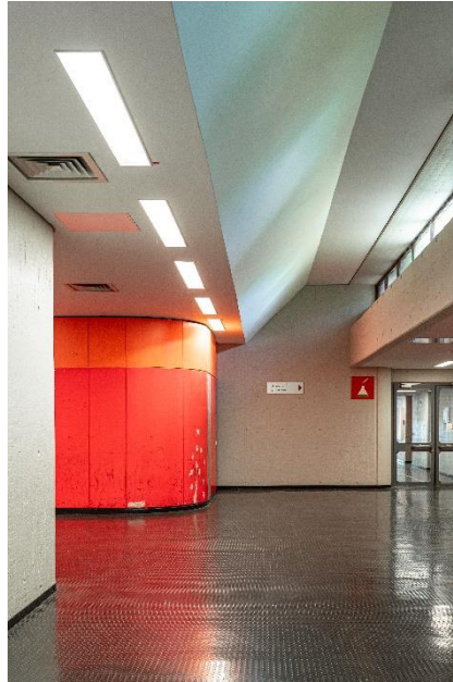
Abb. H: Aktueller Zustand der Faserzementplatten (Foto: Hannah Kraus, 2024)
